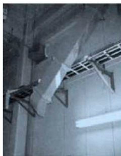
ダクトの破損・落下
