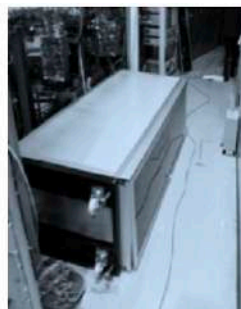
サーバー等の転倒・破損
